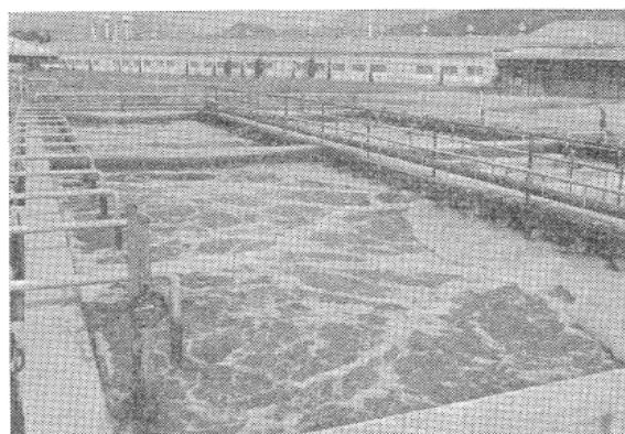
写真2 実施設の曝気槽
