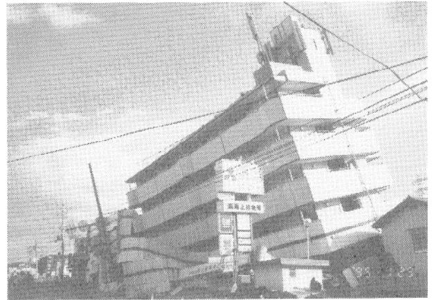
写真7 下層崩壊により全体傾斜した鉄骨造建物
