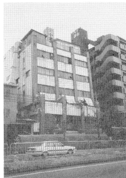
写真3 RC造建物の中間層崩壊
