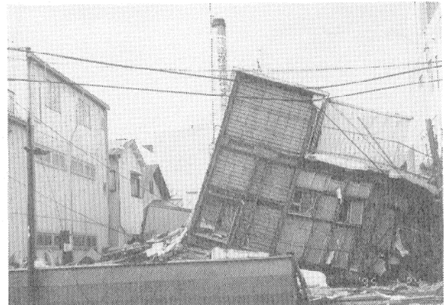
写真8 外壁剥落及び下層崩壊した軽量鉄骨造建物
