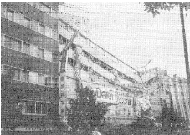
写真1 RC造建物のパンケーキ状崩壊
