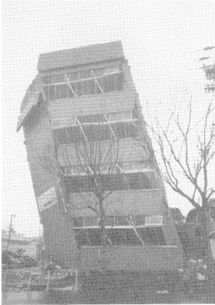
写真4 RC造建物の全体崩壊
