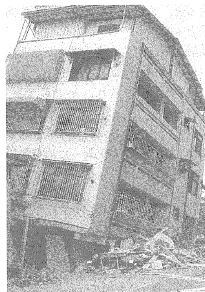
写真8 騎楼建物の被害(霧峰)
