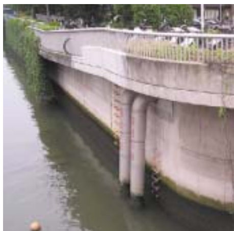
写真4 河川水取水口
