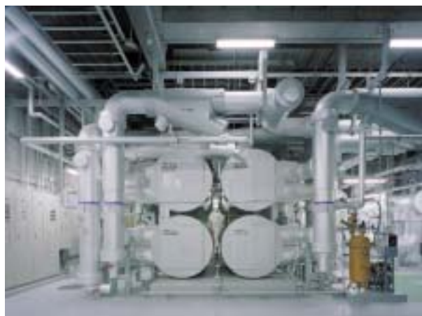
写真5 河川水熱交換器
