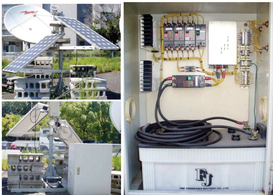
図1：蓄電池を用いた無停電運用システム（人間科学研究科・東館駐車場）
