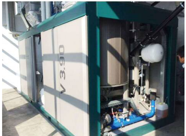
図4 リアクター（木質ペレットガス化炉）部分のパッケージ
