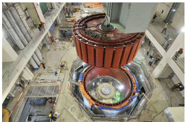
ナム・グム第2ダムのタービン
