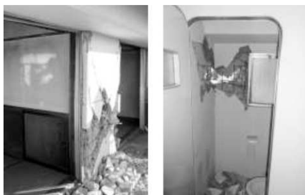
図1 東日本大震災における非構造壁の被害事例（左：バルコニー、右：トイレ）
