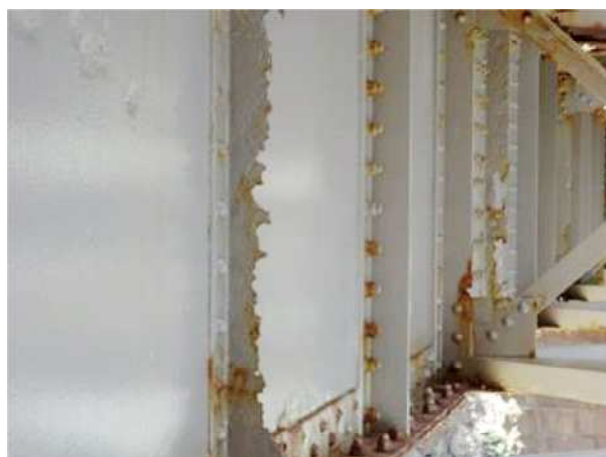
図-1 鋼橋の腐食状況
