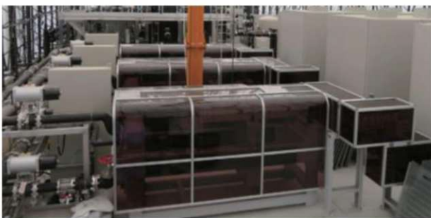
図4 1.5MW水電解装置
